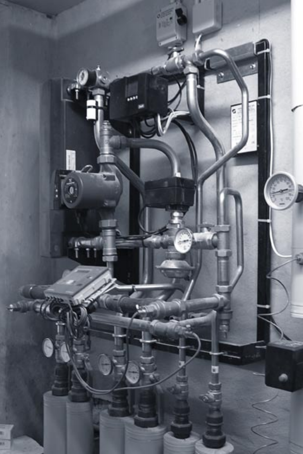
◀ Fjernvarmeinstallation med vejrkompenseringsanlæg. Dette anlæg kan styre fremløbstemperaturen til radiatorer og brugsvand efter behov, hvilket kan føre til besparelser på op til 10 pct.
