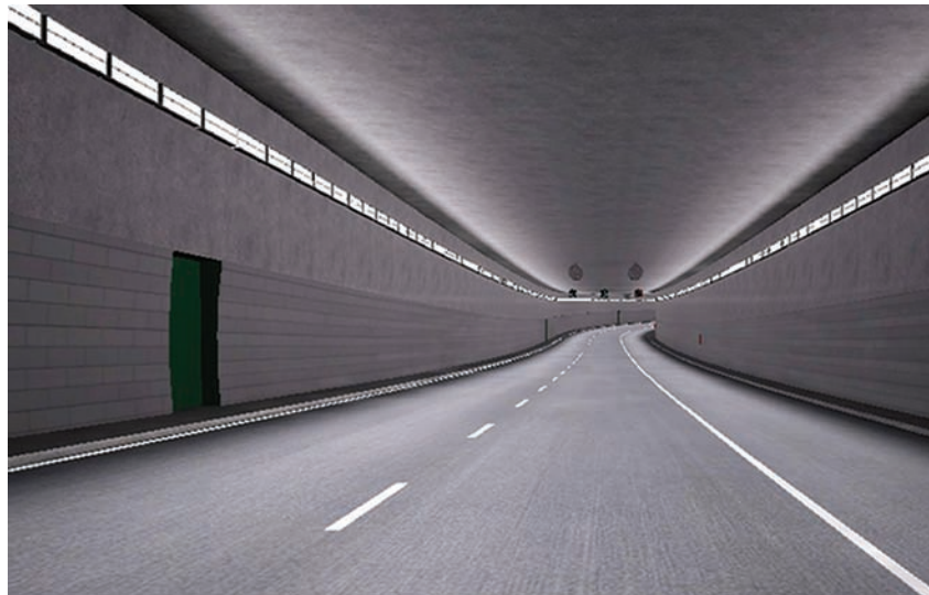
Lys i tunnel, gennemgående lysbånd placeret på væg
