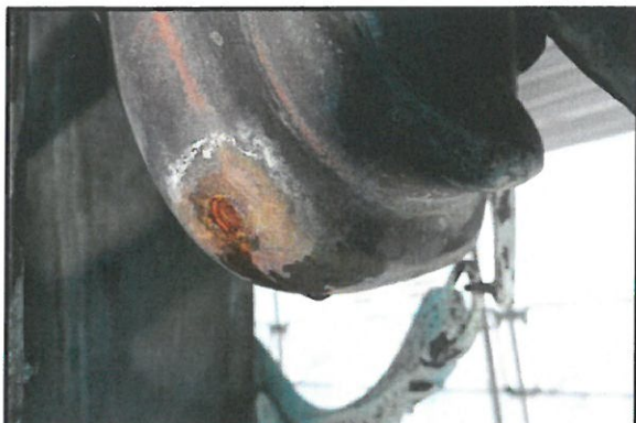
Foto 14: Udfældning langs gammel reparation i støbningen.
