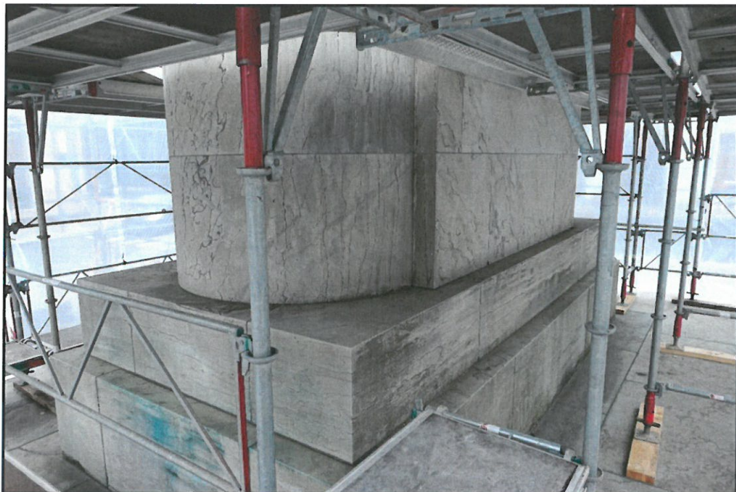
Foto 24: Nedre del af sokkel, nordside før behandling.
