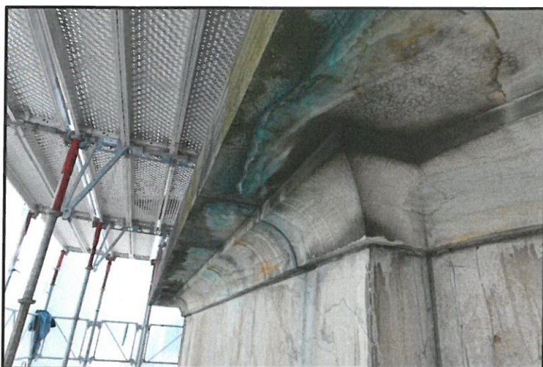
Foto 16: Gesimsens underside med misfarvning fra kobber, gips, biologisk vækst og rust.
