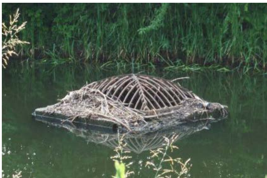
Figur 8 Overfaldsskakt fra Fæstningskanalens nedre bassin til Harrestrup Å.
