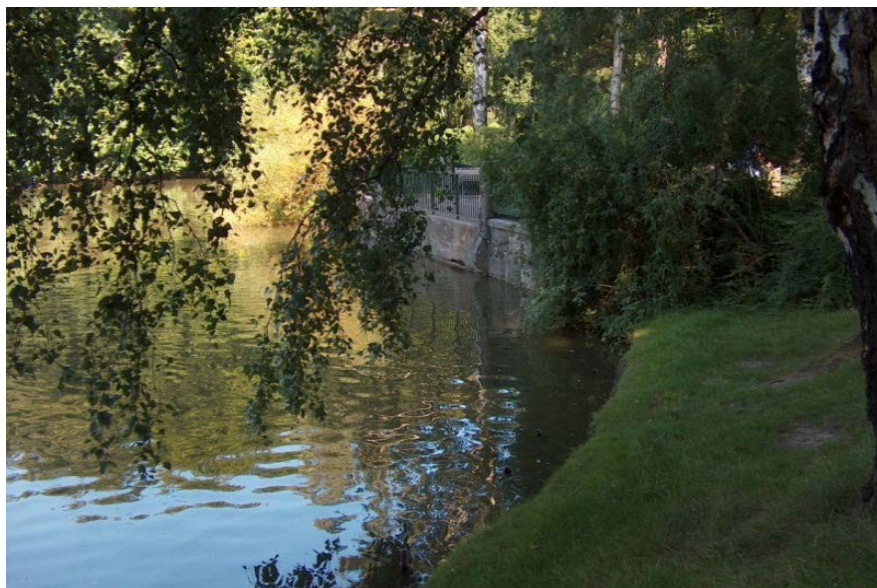
Figur 22 Indløbsbygværk ved Fælledparksøen.
