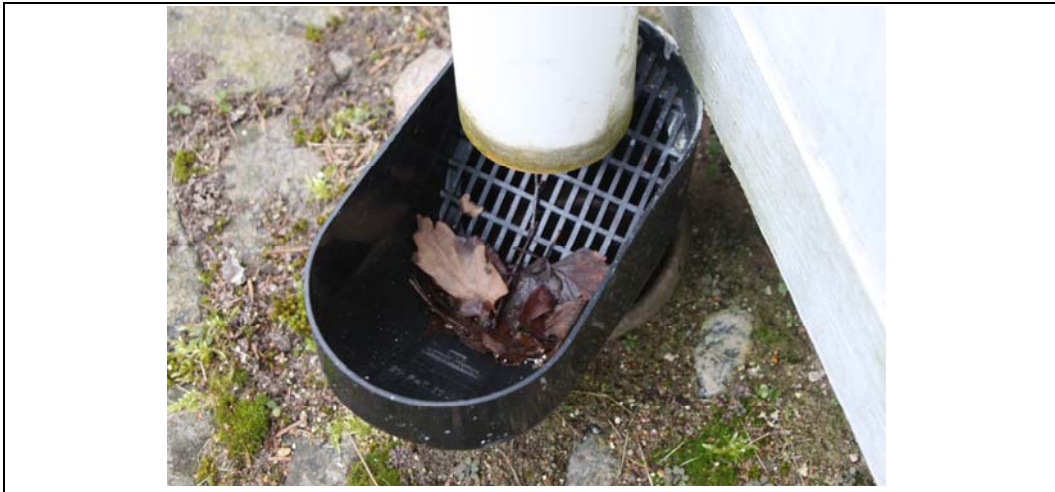
Figur 3.1 Grovfilter på tagnedløb
