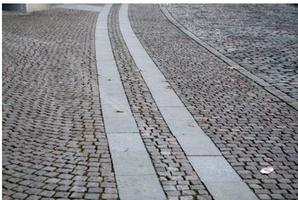
Bordursten i granit mellem chaussesten
