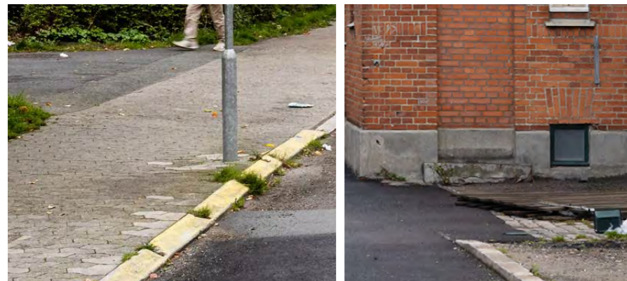
01-2 Slidte betonfliser, SF sten og asfalt belægninger.
