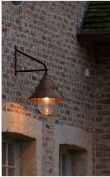
Særlig belysning ved indgange
